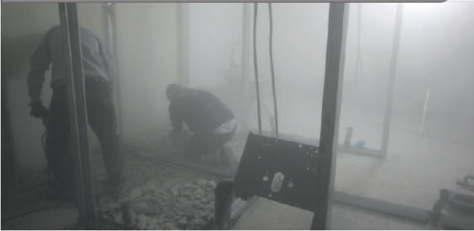
Smutsig luft efter bilning och kaping i betonggolv.
